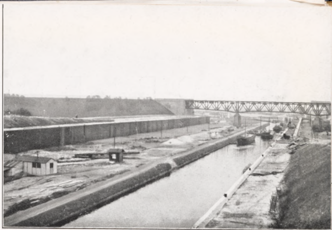
Fig. 201. Aspect du chantier Haccourt-Briegden. Au centre l'ancien canal et sur les berges les murs-digues.
